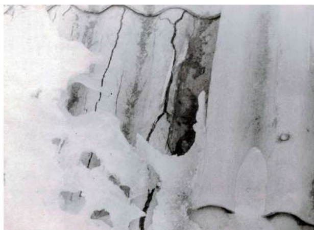
Рисунок 1 – Невентилируемая кровля животноводческого здания, разрушенная под влиянием влаги Figure 1 – Non-ventilated roof of the livestock building, destroyed under the influence of moisture
