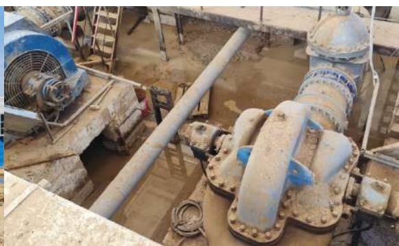
Рисунок 2 – Машинный зал. Общий вид Фото Трушева В. В. Figure 2 – Engine room. General view Photo by Trushev V. V.
