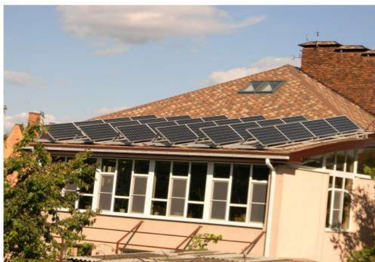
Рисунок 1 – Фотоэлектрическая станция в сельском районе Ростовской области Figure 1 – Photovoltaic plant in a rural area of the Rostov region
