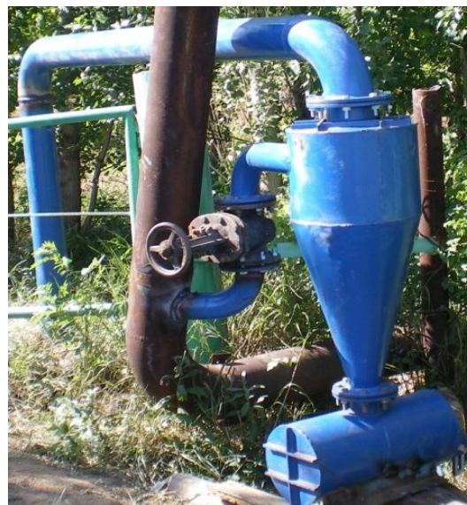
Рисунок 2 – Установка очистки воды для систем капельного орошения
