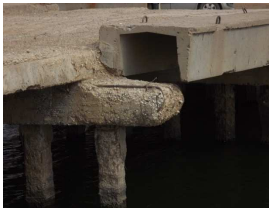
Фото 2 – Разрушение опорной части мостового перехода
