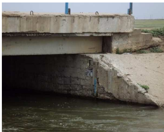
Фото 1 – Разрушение железобетонных конструкций плотины
