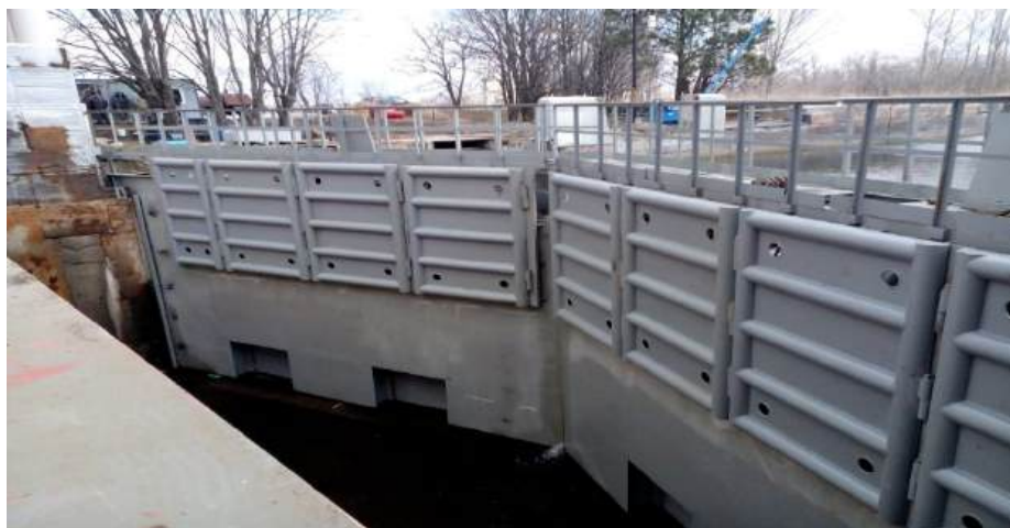
Рисунок 1 – Состояние поверхностей металлоконструкций в начале эксплуатации (фото: Д. Ю. Чупров, ФБУ «Администрация «Волго-Дон», 2023)
