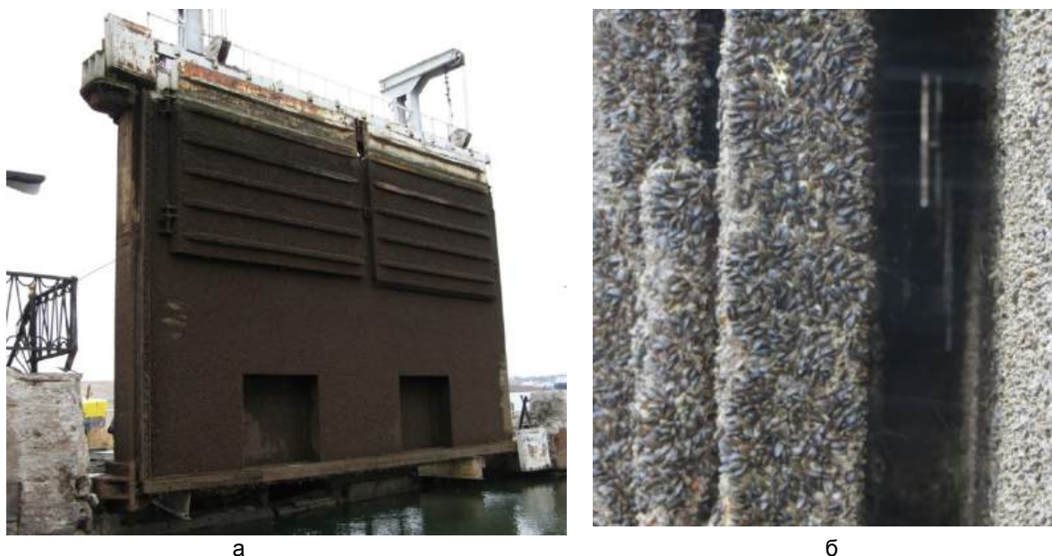
Рисунок 3 – Обрастание подводной части металлоконструкций (фото: Д. Ю. Чупров, ФБУ «Администрация «Волго-Дон», 2022): а – общий вид; б – фрагмент Figure 3 – Fouling of the underwater part of metal structures (photo: D. Yu. Chuprov, Volga-Don Administration, 2022): a – general view; b – fragment
