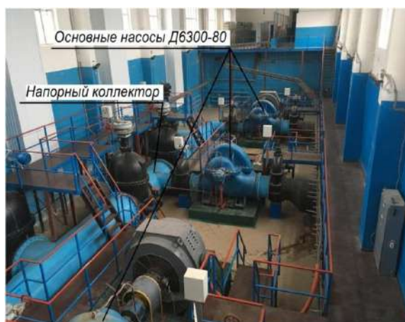
Рисунок 2 – Машинный зал. Общий вид Figure 2 – The machine room. General view
