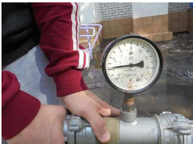
Рисунок 9 – Манометр на распределительном трубопроводе. Фото В. В. Трушева Figure 9 – Pressure gauge on the distribution pipeline. Photo by V. V. Trushev
