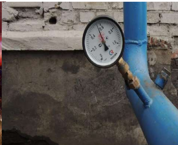
Рисунок 8 – Мановакуумметр на всасывающем трубопроводе Figure 8 – Manovacuummeter on the suction line
