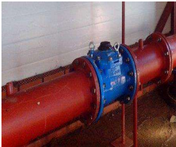
Рисунок 7 – Измерение расхода в напорном трубопроводе Figure 7 – Flow measurement in the pressure line
