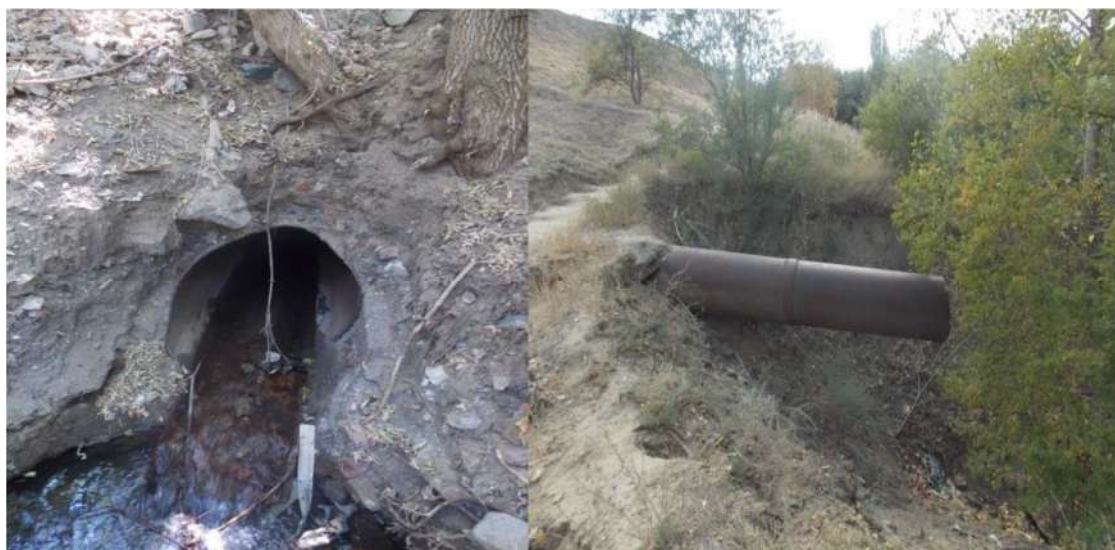
Рисунок 6 – Канализационные водовыпуски / Figure 6 – Seweroutlets
