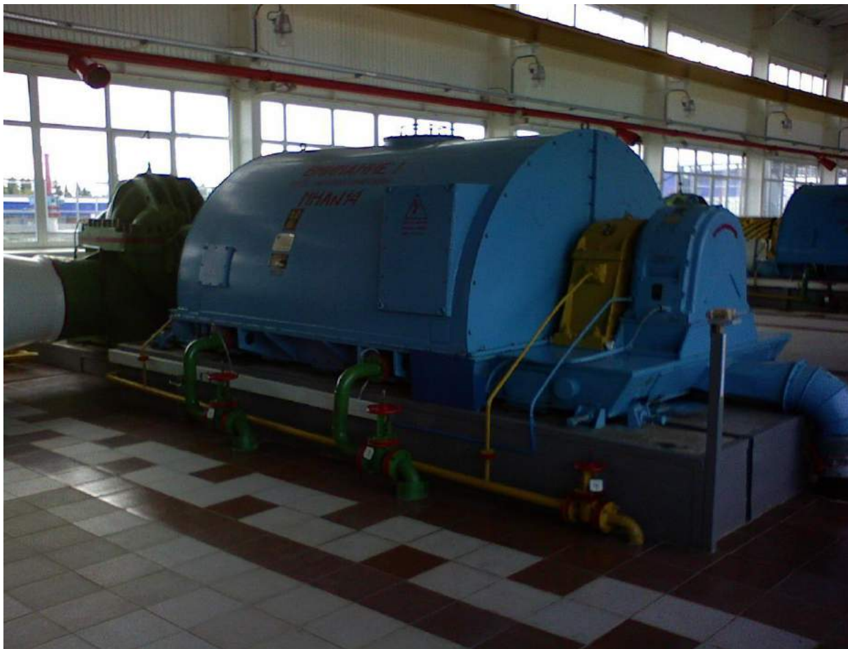
Рис. 4.5. Насосная внешней перекачки нефти с электроприводом
