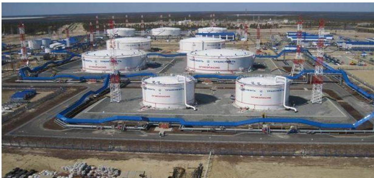
Рис.1.6. Головные сооружения (центральный пункт сбора и подготовки нефти и газа)
