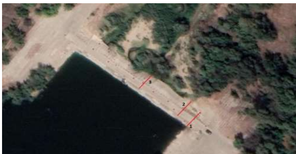
Рисунок 8 – Участки локального повышения влажности грунта, пересекающие тело плотины
