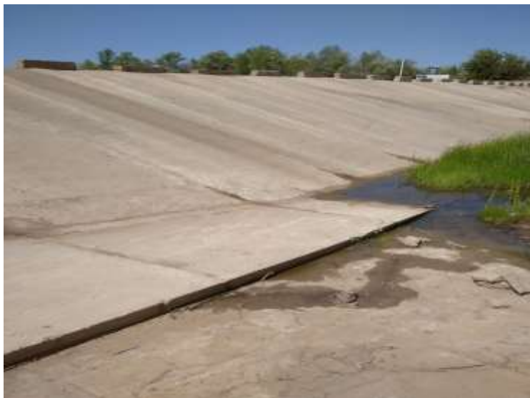
Рисунок 9 – Истечение фильтрующей воды на участке № 2 Figure 9 – Filtered water outflow at site No. 2
